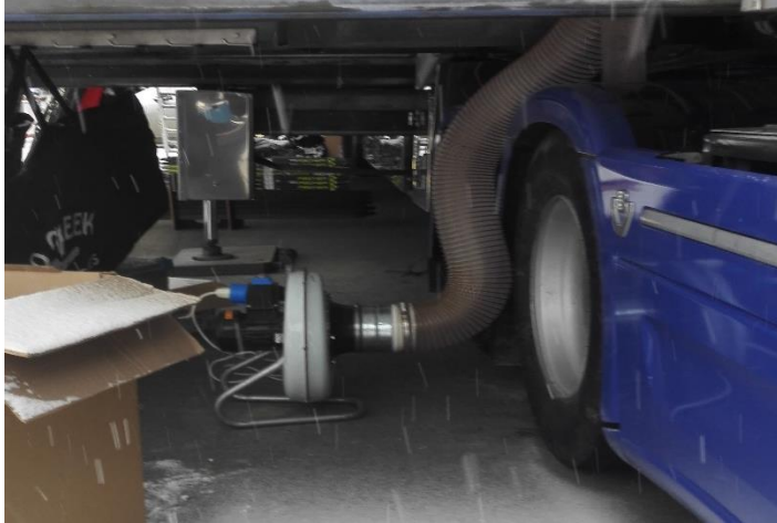
Figur 4: Viften som driver avtrekket i smøreprofilen i pulverrommet.
